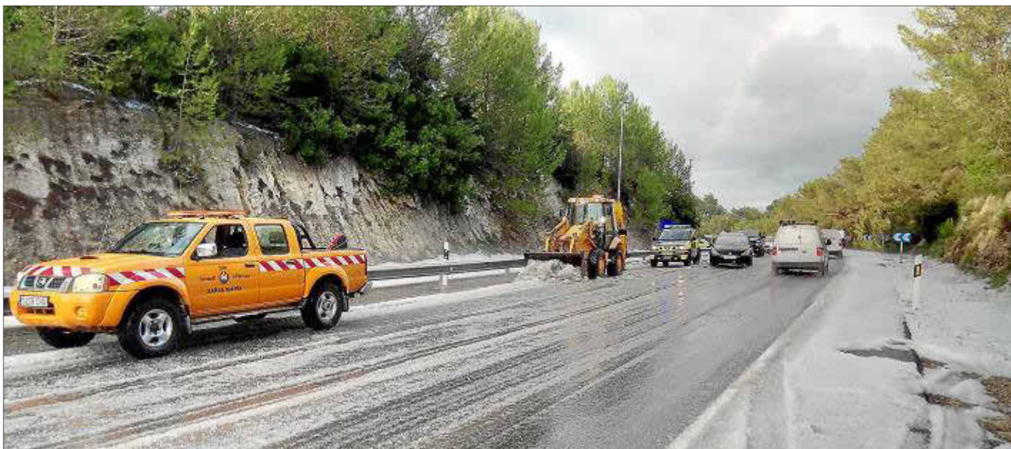
Maquinaria y operarios de Carreteras del Consell d'Eivissa trabajan para retirar el granizo en una vía, ayer. Foto: CONSELL D'EIVISSA
